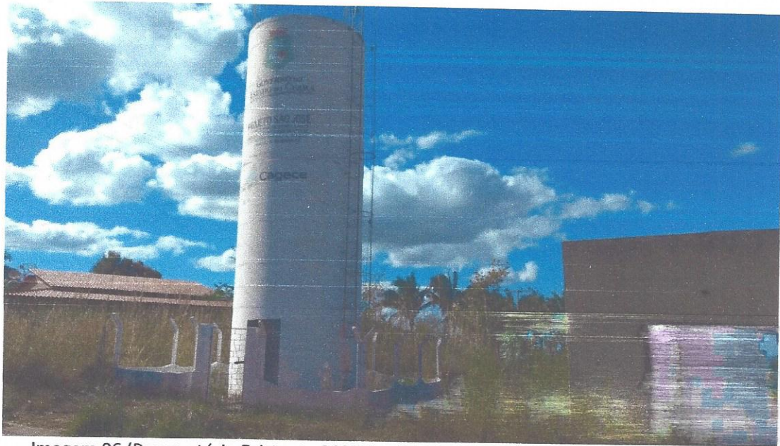
Imagem 06 (Reservatório Existente 21000L - Angolas – Cota 690 – Lat 7°21'18.17"S Long 39°23'55.58"O)
